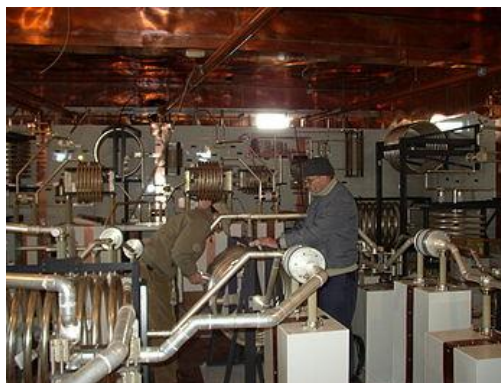
ATU para una antena AM de 250 KW y 6 torres
