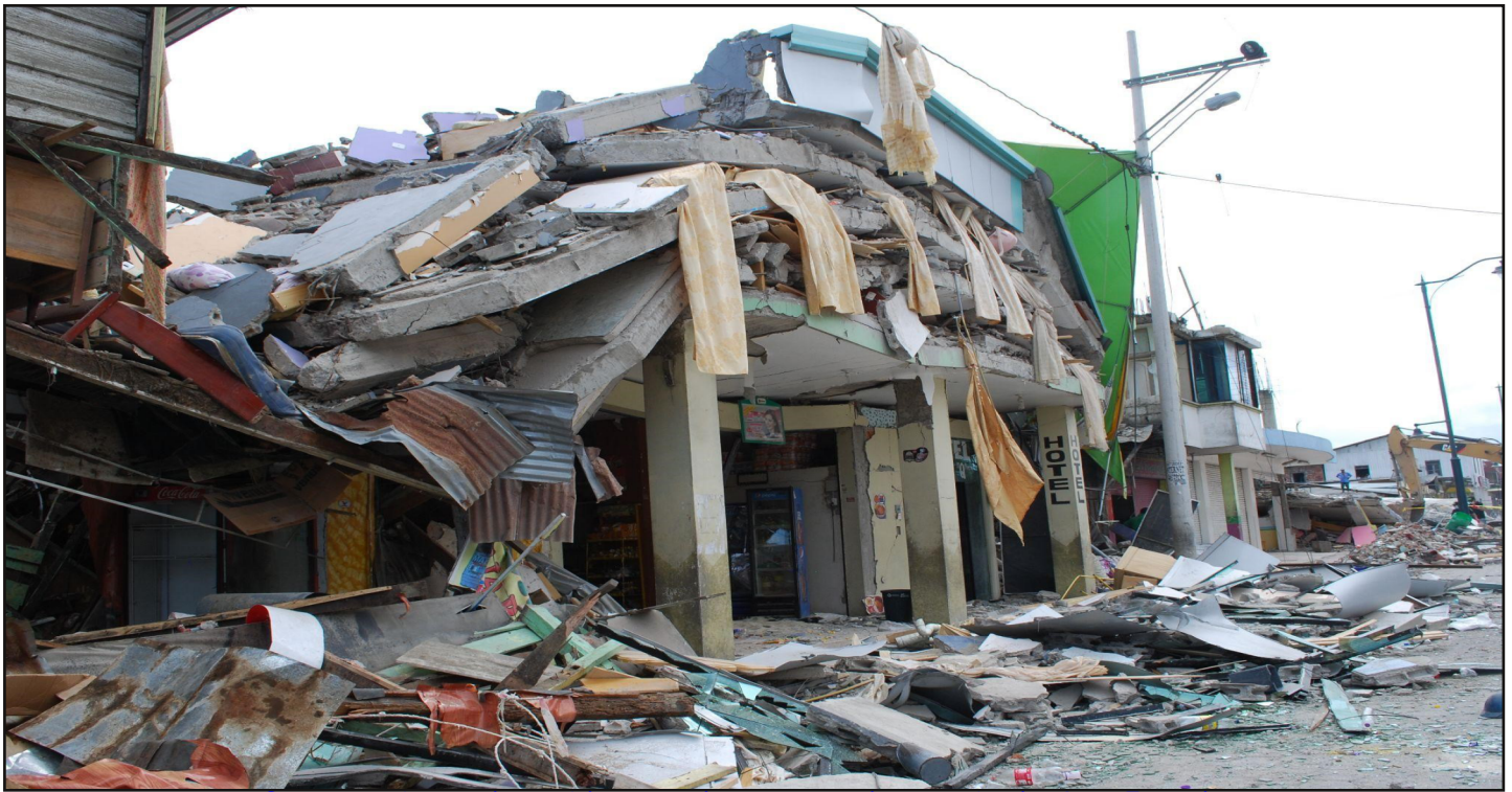
Construcciones destruidas por el terremoto de magnitud 7,8 en Ecuador (Gentileza Cruz Roja Ecuatoriana)
