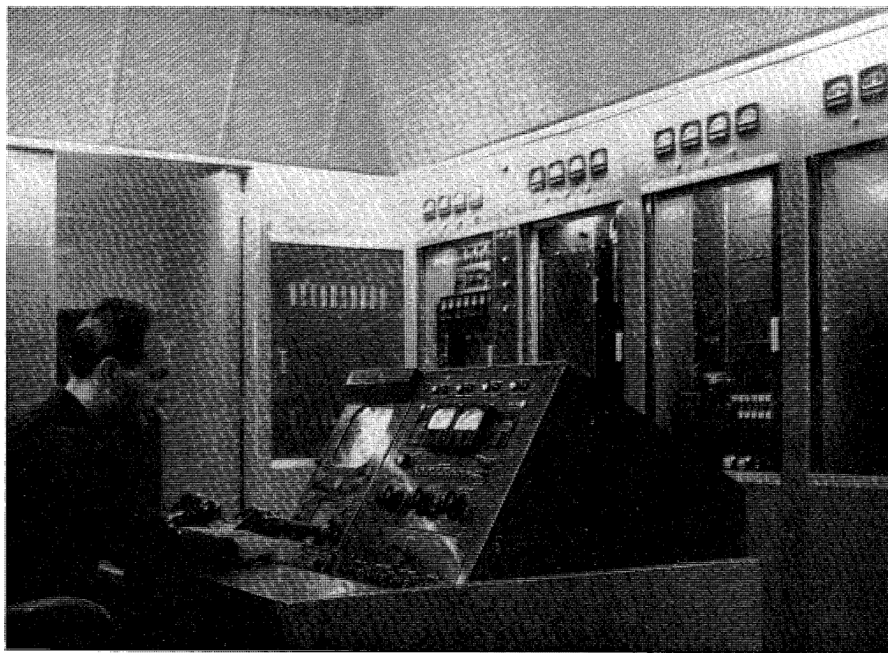
Pupitre de mando y control de la estación transmisora de Las Dos Castillas (Navacerrada).
